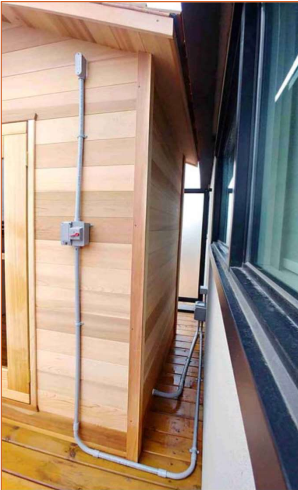
Conduit résistant aux intempéries et interrupteur d'éclairage
